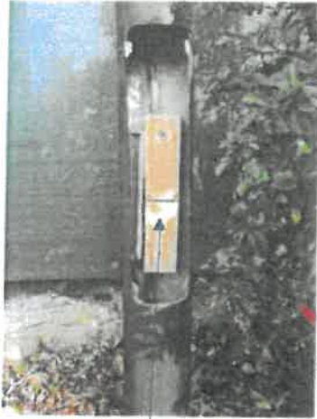
Branchement électrique dans le candélabre en bas
